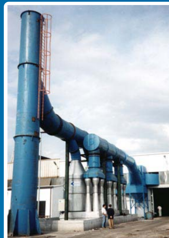
ECOCHIMICA SCRUBBER PLANT FOR AMINES TREATMENT IMPIANTO SCRUBBER ECOCHIMICA PER ABBATTIMENTO AMMINE
